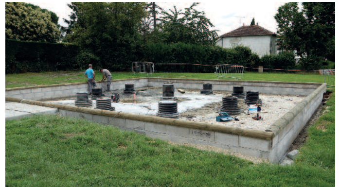
Murets, plots de fixation et bordures de sécurité.
